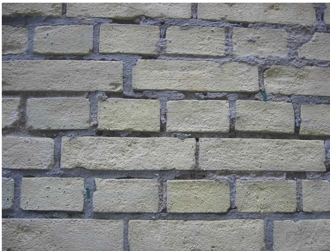
Højtryksspulet murværk – der efter afrensningen er mere eller mindre ødelagt.
